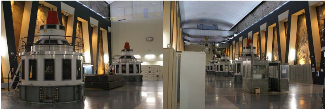
Sala de Turbinas – Aldeadávila I
